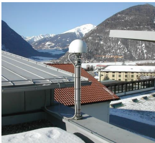
Esempio di stazione permanente
