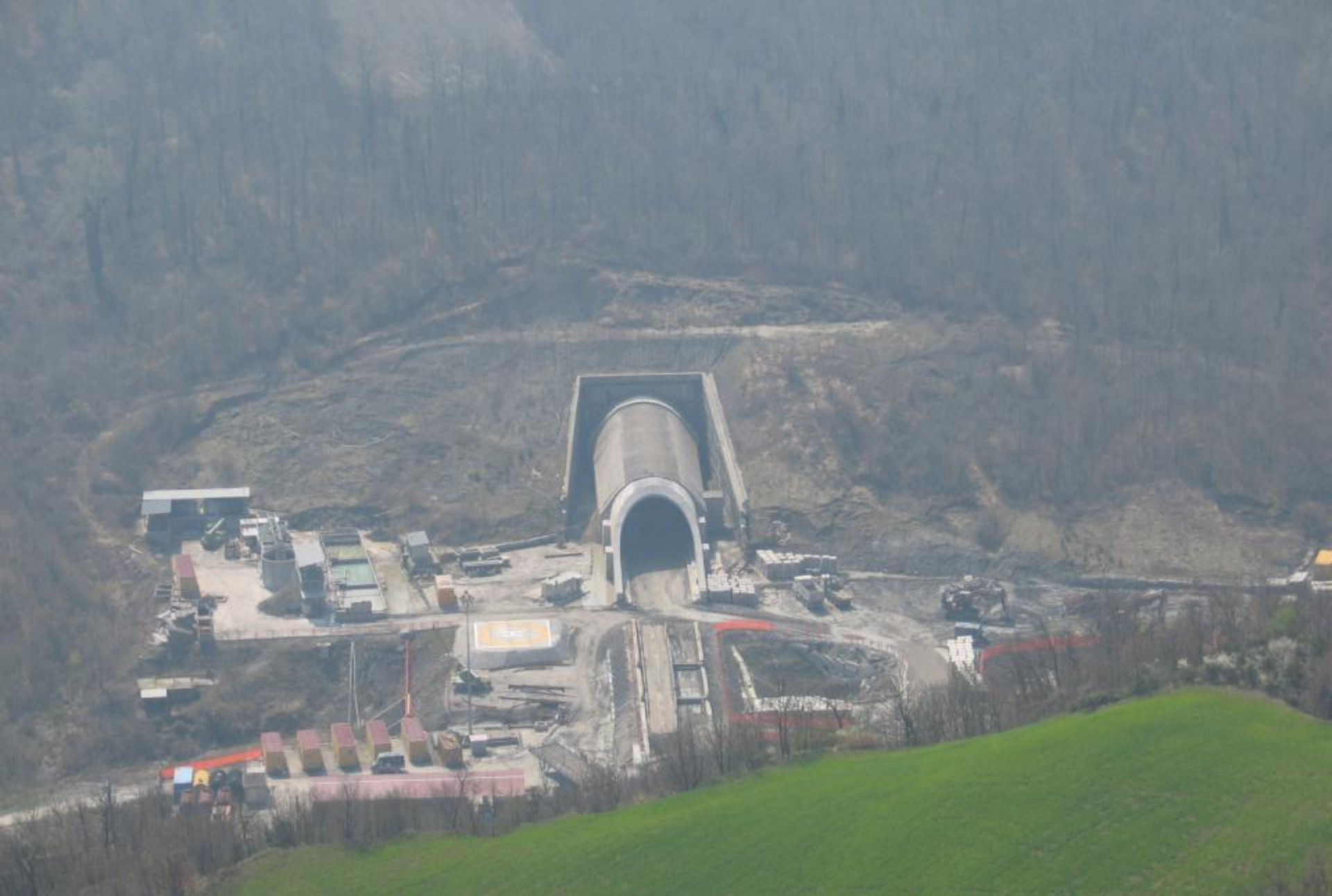
1331 - Qc - Cantieri, spazi in costruzione e scavi - Pianoro (BO) foto di Stefano Corticelli 04/2006
