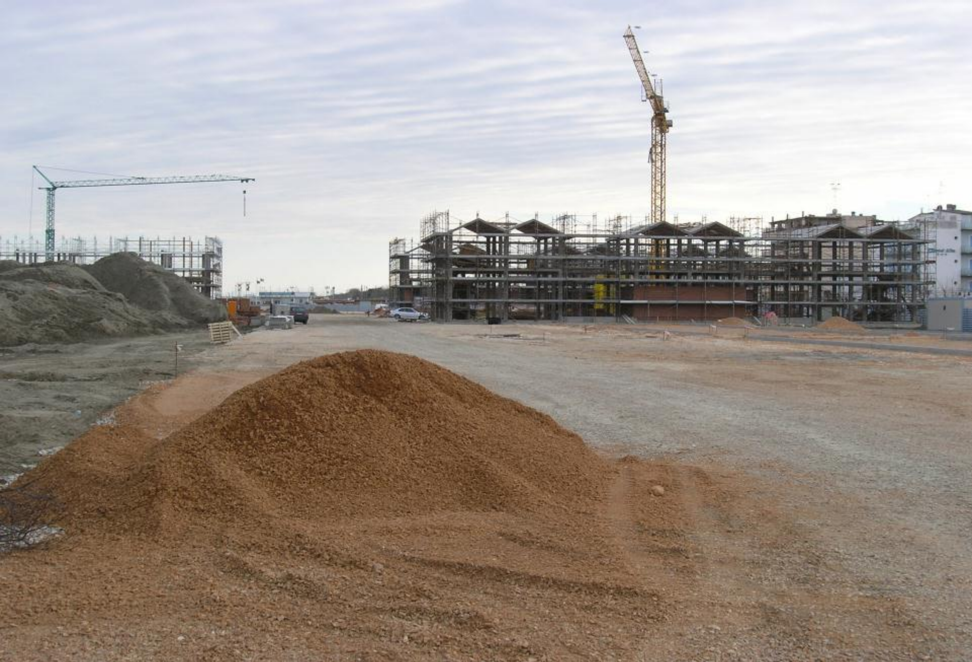
1331 - Qc - Cantieri, spazi in costruzione e scavi - Ravenna foto di Barbara Guandalini 03/2006
